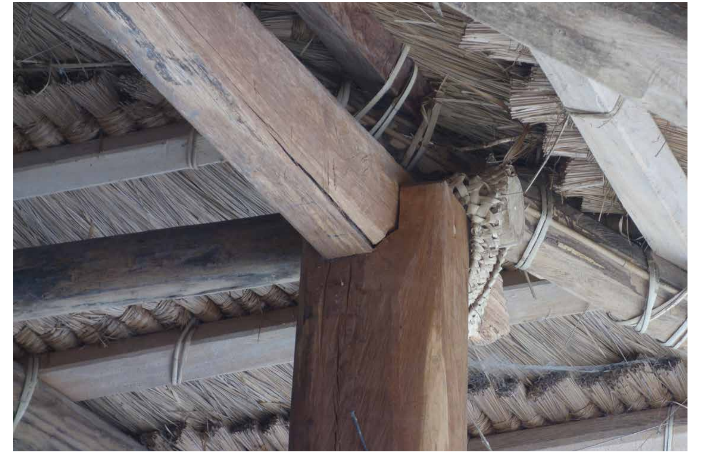
Fig. 5 : Maison royale de Lewa Paku, au centre de l'île (district de Lewa). Détail de la partie de la charpente surplombant la véranda. Les assemblages sont simples : une cuvette aménagée à l'extrémité du poteau reçoit la panne sablière ; chevrons et liteaux sont fixés à l'aide de liens végétaux. © Anthony Denaire, 2018
