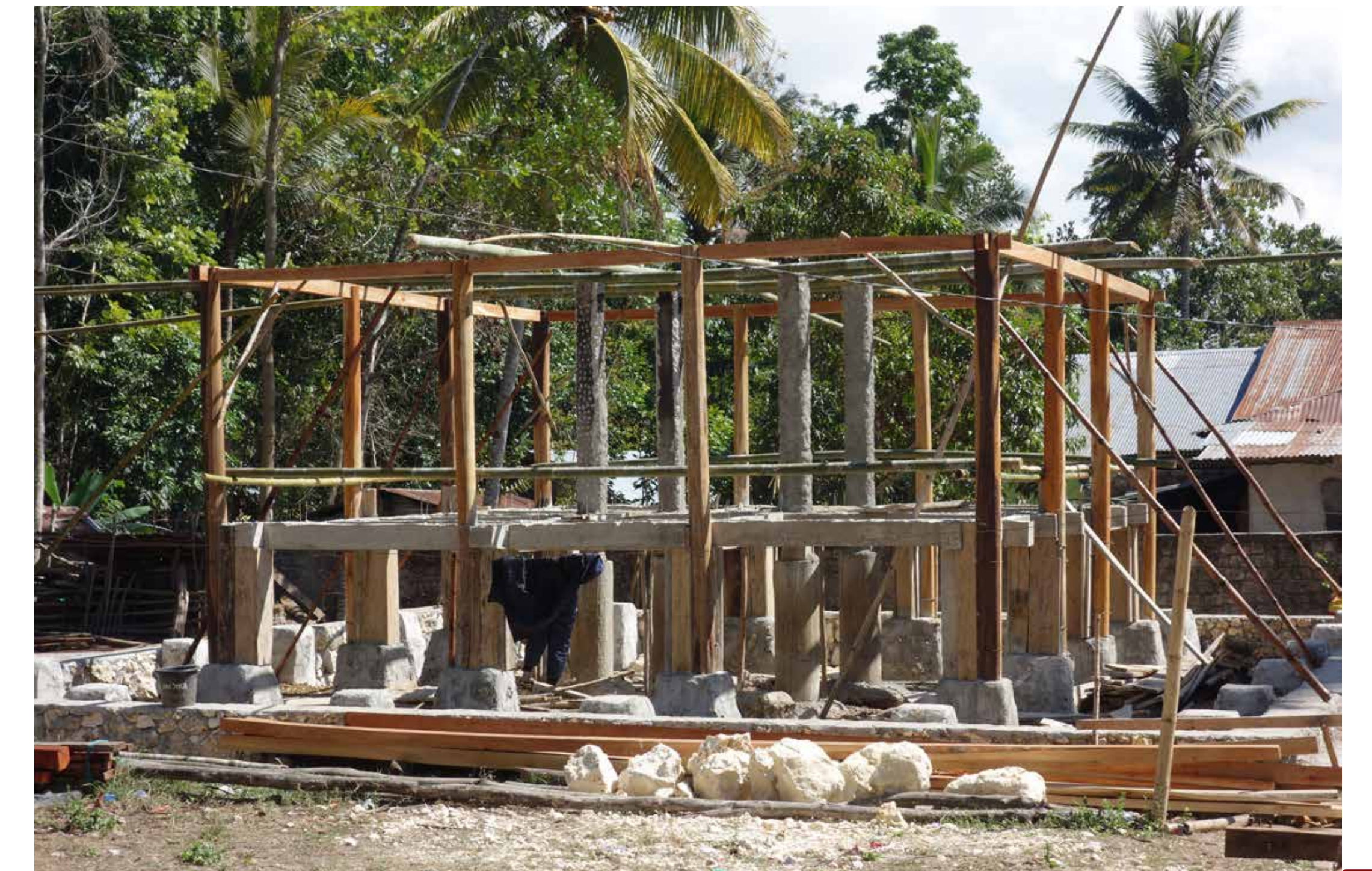
Fig. 3 : Vue d'une maison en cours de construction au pied du hameau de Kalimbu Jaga (district Lolli). Les élévations sont toujours en bois, mais le béton armé remplace de plus en plus ce matériau, notamment pour les quatre gros piliers centraux et les poutres supportant le plancher surélevé. Les plots et les murets sur lesquels reposent les autres poteaux en bois sont en béton ou en moellons cimentés. © Anthony Denaire, 2018
