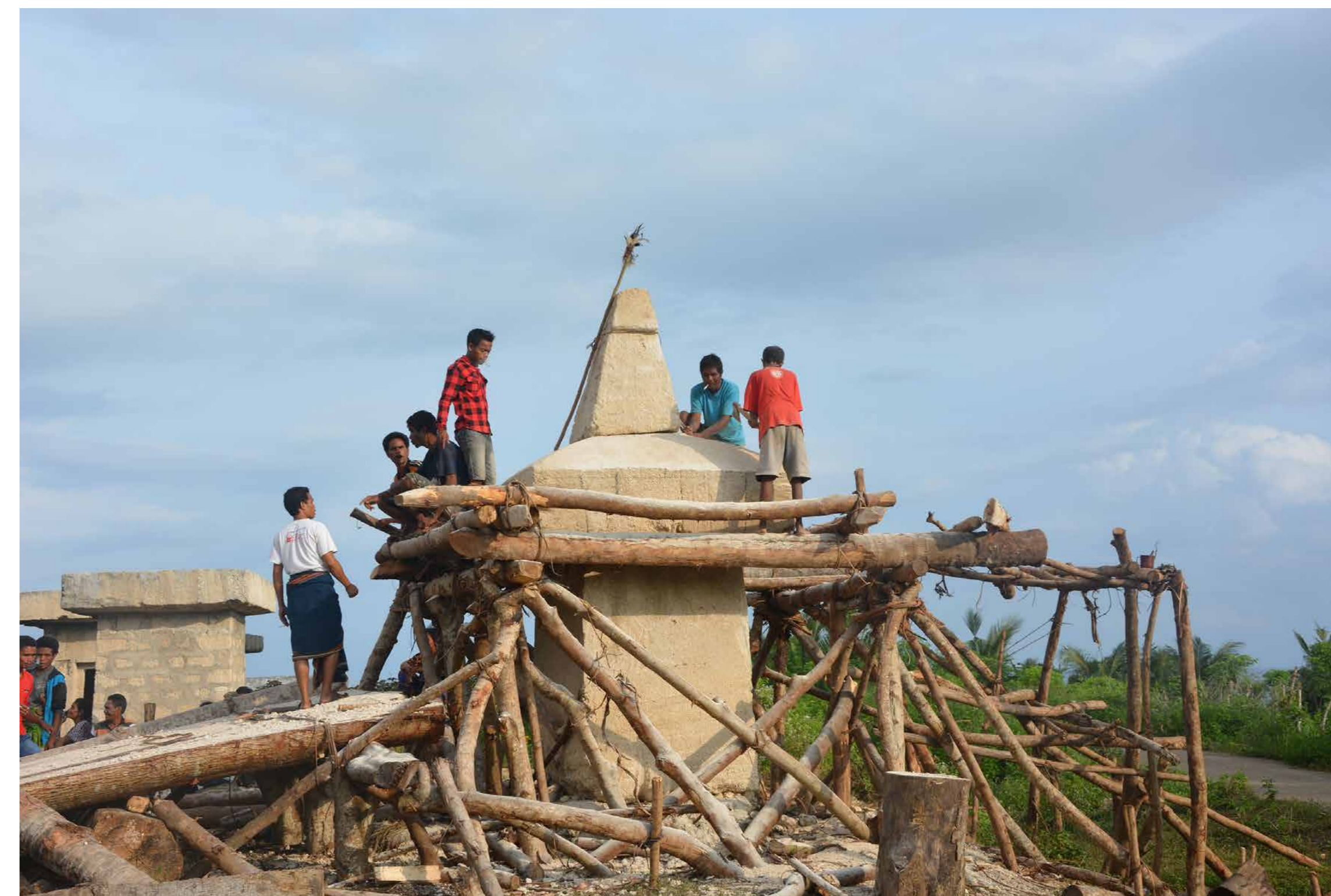
Mise en place d'une stèle funéraire sur l'île de Sumba, en Indonésie. © Anthony Denaire
